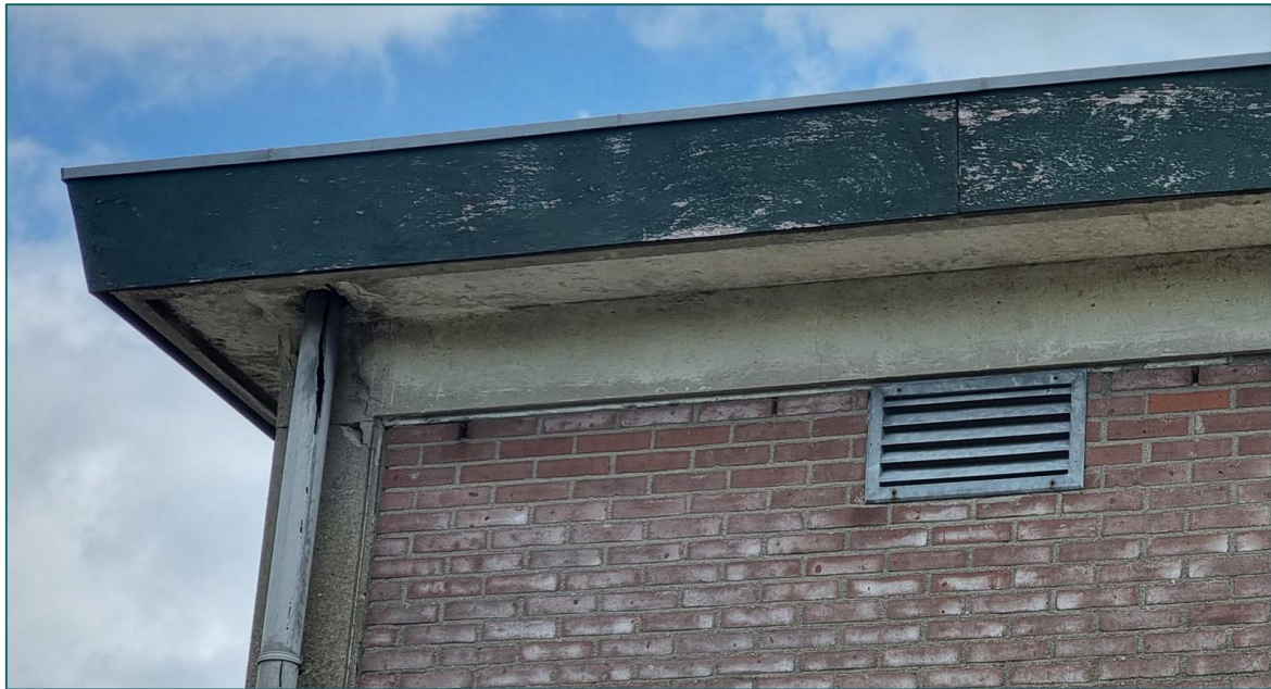
Figuur 3.3 Open stootvoegen in de noordwestelijke gevel van het hoofdgebouw kunnen vleermuizen toegang tot de spouwmuur verlenen.
