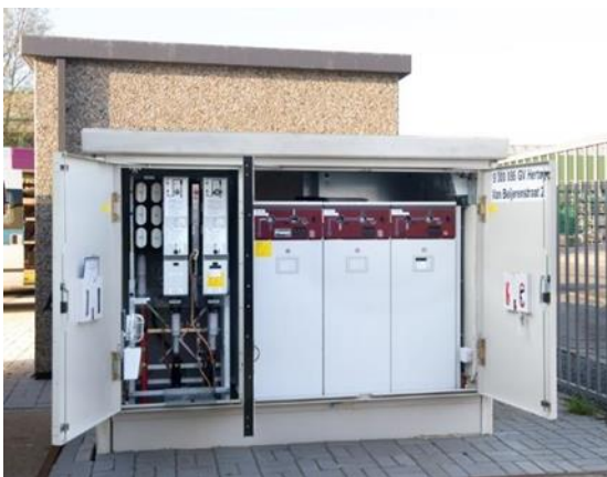
Figuur 3: foto middenspanningsruimte
