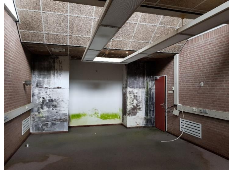
Figuur 66. Impressie zaal met systeemplafonds, waterschade.
