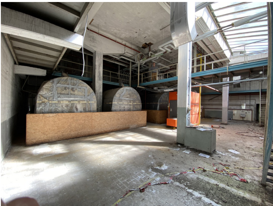
Het interieur van het ketelhuis
